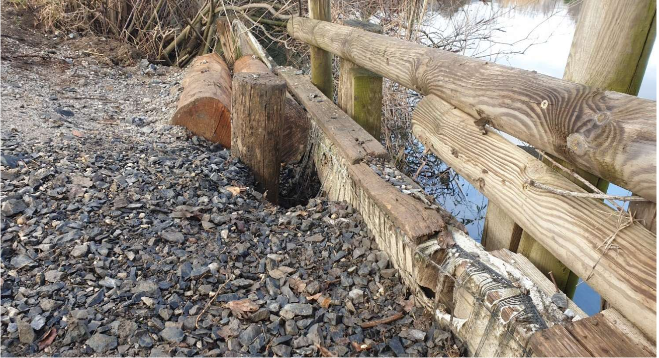
Figura 3: Geotessuto mancante e/o strappato lungo le protezioni spondali in legno.
